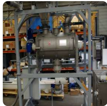
➤ Skid de mélange pour la débactérisation de la poudre d'algue (application cosmétique)
