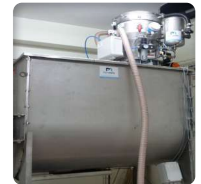
► Chargement transport pneumatique sur mélangeur en auge
