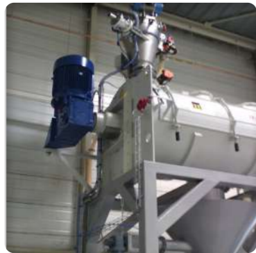
➤ Chargement du mélangeur par transport pneumatique
