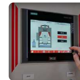
Automate pour le contrôle à distance
