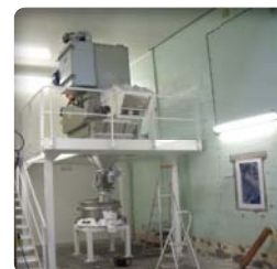
▶ Installation poudre de lait
