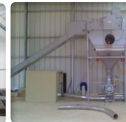
▶ Déconditionnement de ciment avec transfert pneumatique
